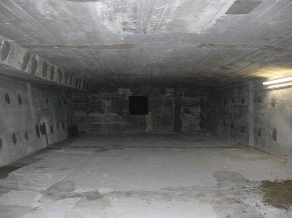
Anhang 3: Hohlraum in Brücke
