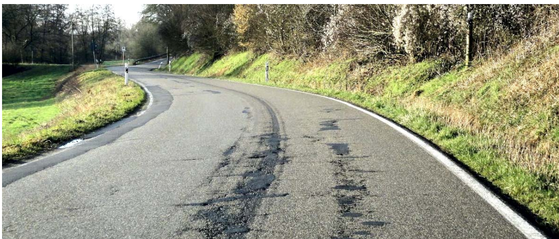
Abb. 8: Schadensbilder der L465
